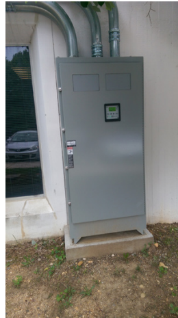
Existing 800A ATS
