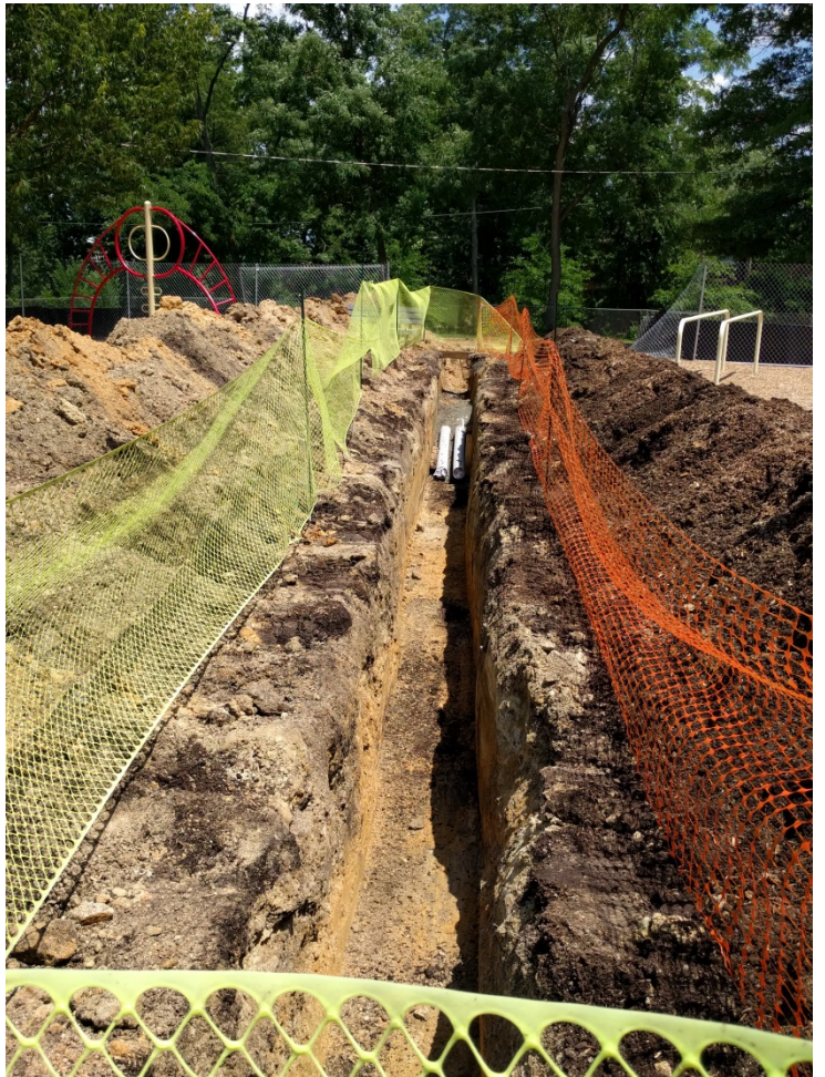
New electrical service conduits
